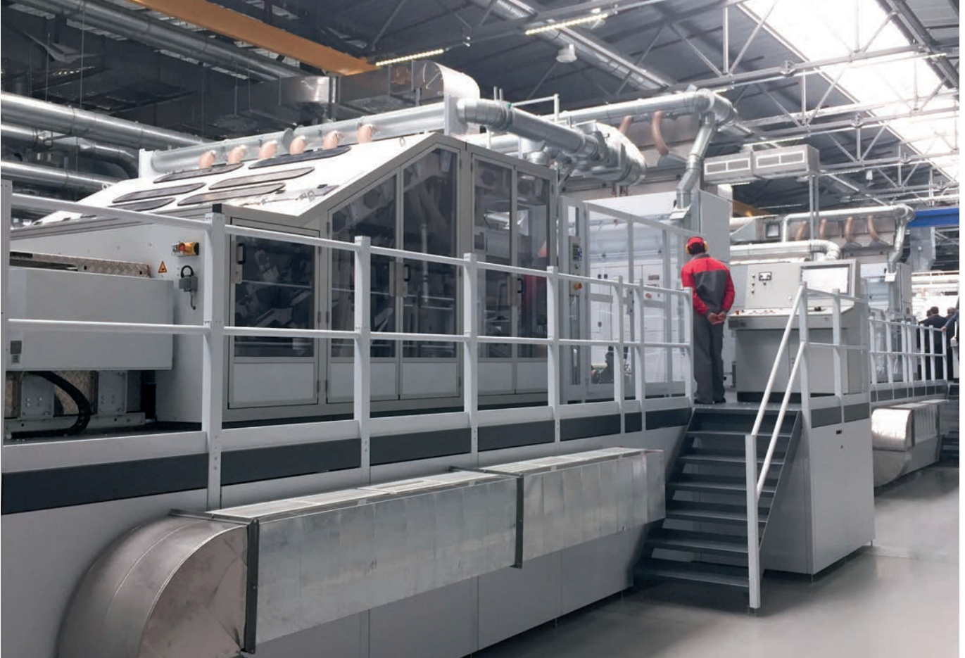
Dokunmamış pamuklu kumaş tesisi
